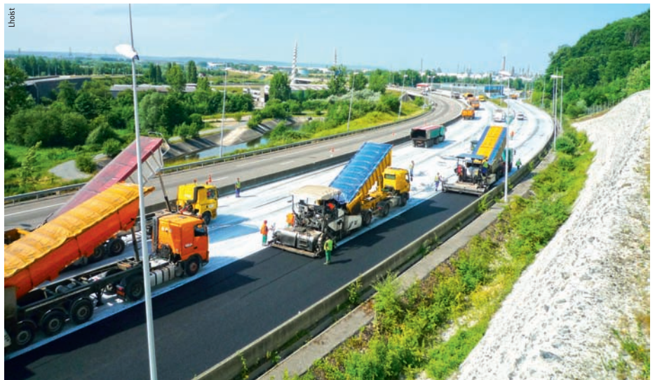
Photo 1 Mise en œuvre d'enrobés sur l'autoroute A29 en France avec couche de collage traitée au lait de chaux Laydown of asphalt on French motorway A29 with lime-milk treated tack coat
