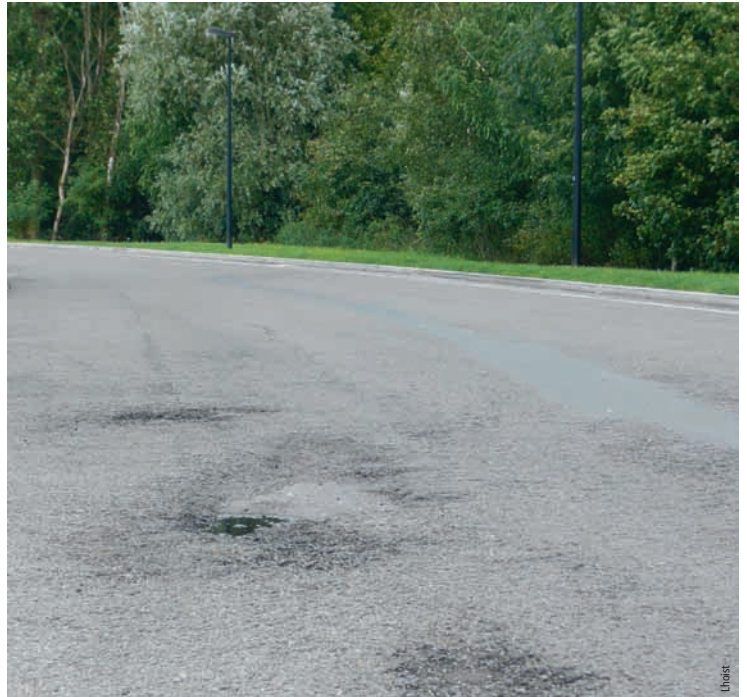
Les dégâts hivernaux observés sur les routes après les hivers rigoureux peuvent se manifester par la formation de nids-de-poule. La présence de chaux hydratée dans les enrobés bitumineux est une solution prometteuse visant à limiter l'occurrence de ces phénomènes
